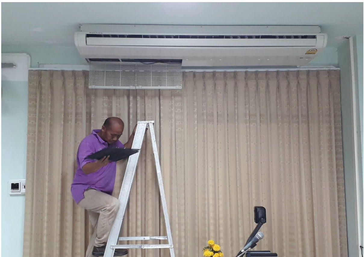
ทำความสะอาดกรองอากาศเครื่องปรับอากาศ ภาคเรียนละ 1 ครั้ง
